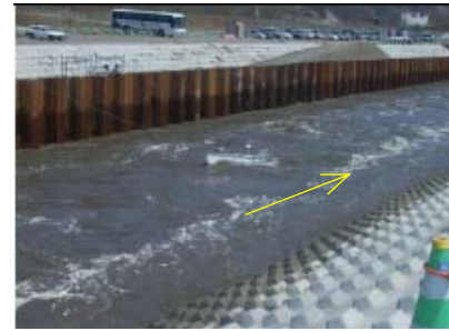
図-9 濁水の発生状況
